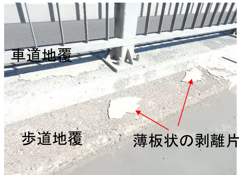
2015年地覆打替え(凍害危険度5) 含浸材ならではの劣化形態
