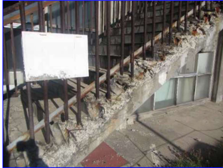
屋外階段の劣化(53 年経過)、凍害危険度2
