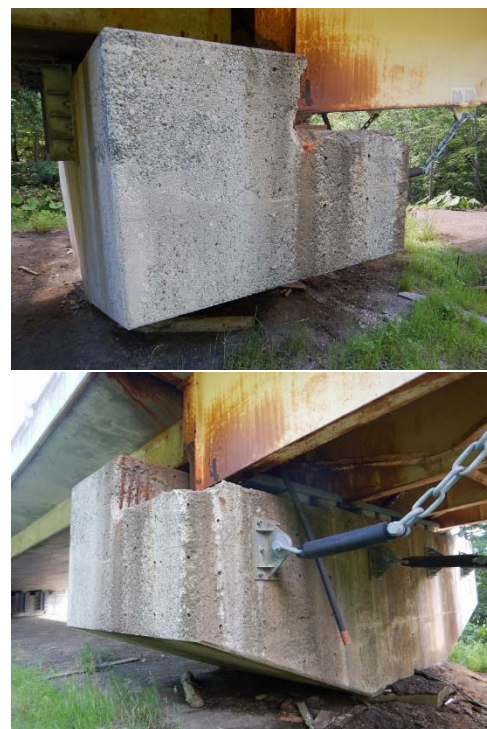
写真-2 1986 年建設の橋脚の劣化状況
