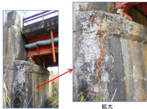
写真-1 1954 年建設の橋台の劣化状況
